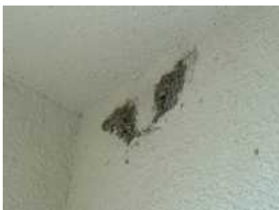
プールサイドにあったツバメの巣の跡
